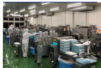
空調管理された作業所。
